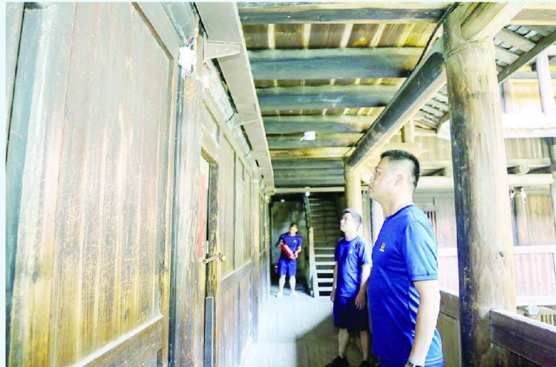
在和贵楼楼内,消防人员检查消防设备运行情况。 庄伟杰 摄
