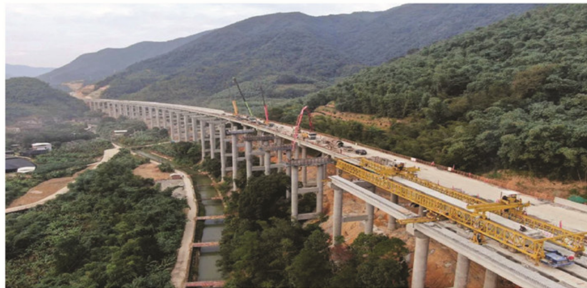
省重点项目漳武高速(南靖段)A2标段,外马坪1号大桥全幅顺利贯通。韩佳候 摄
